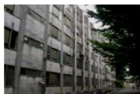
落下の危険がある外壁
