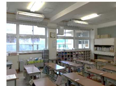
空調設備・換気設備を備えた教室
