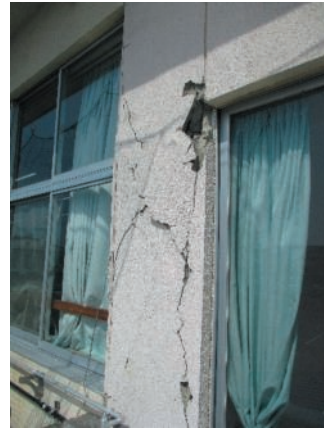
令和4年3月の福島県沖を震源とする地震で生じた外壁の亀裂
