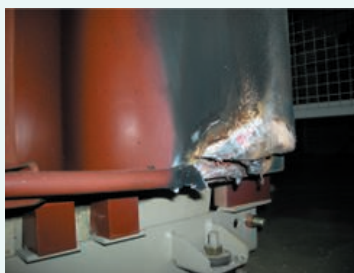
変圧器の発火による損傷
