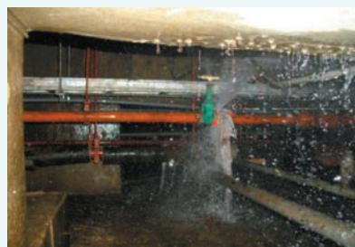
配管からの漏水
