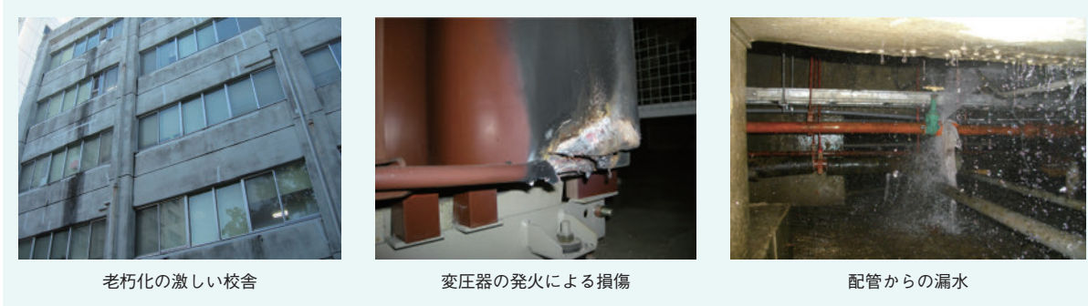
図表 2-12-9 国立大学等施設の老朽化状況
