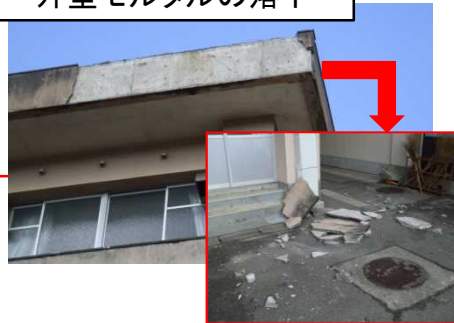
外壁モルタルの落下
