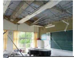
音楽室の天井材の脱落
