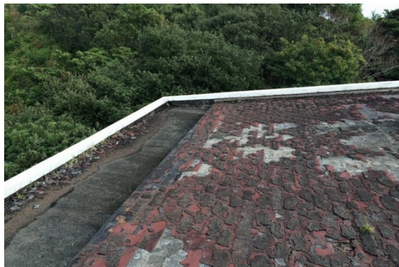
写真 防水材のはがれ／要補修
