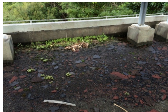
写真 屋上の雑草繁茂／要清掃
