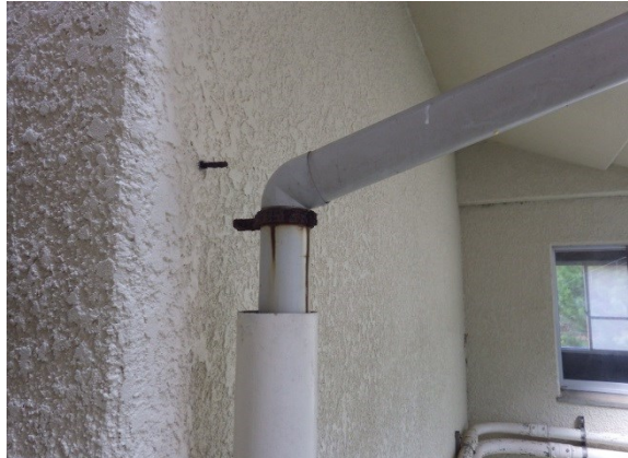
写真 縦樋支持金物破損／要是正
