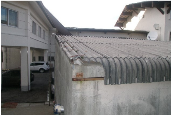
写真 スレート屋根破損／要是正
