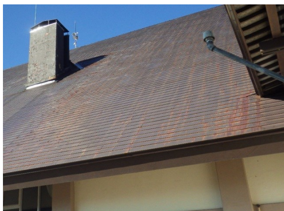
写真 屋根材 錆／要メンテナンス
