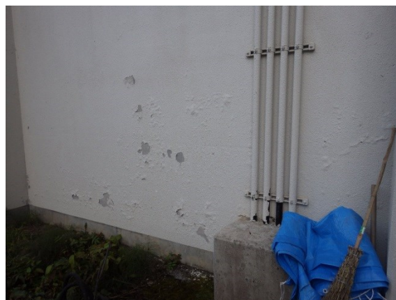
写真 外壁のはがれ／要補修
