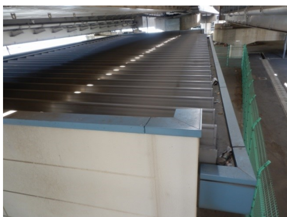
写真 屋根ゴミ／要清掃
