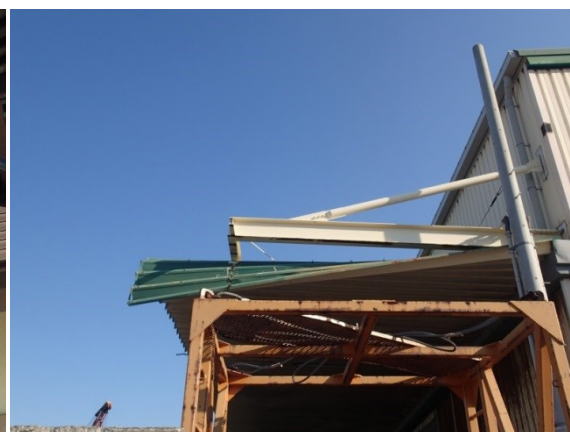
写真 屋根材 破損／要補修
