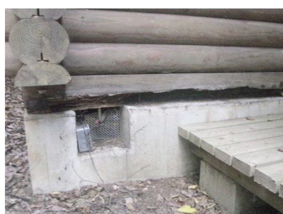
写真 土台の腐食／要是正
