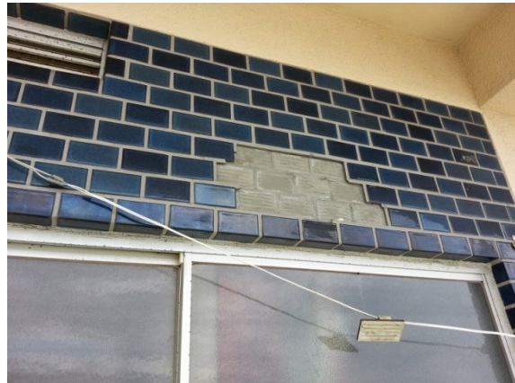
写真 外壁（タイル）のはがれ／要是正
