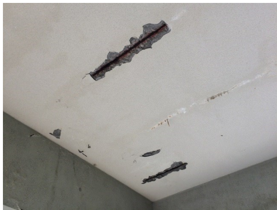
写真 コンクリート爆裂／要是正
