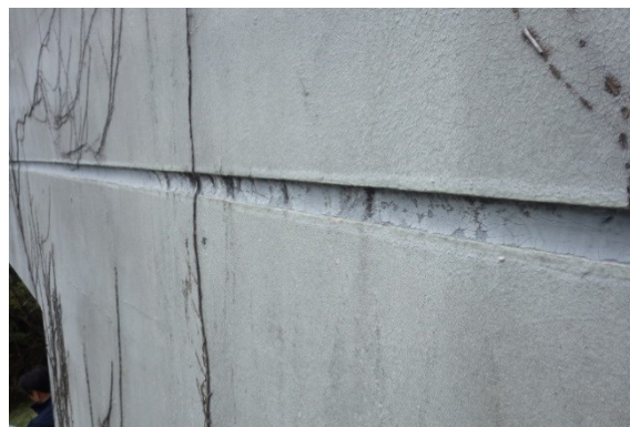
写真 外壁シールの劣化／要補修
