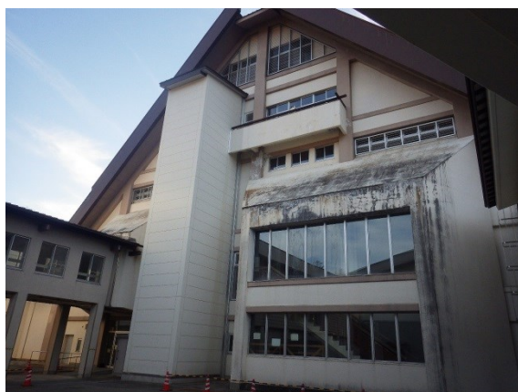
写真 外壁の剥落／要補修
