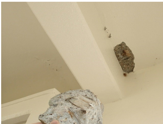
写真 コンクリート片落下状況／要是正
