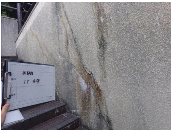
写真 鉄筋のサビ汁が発生／要是正
