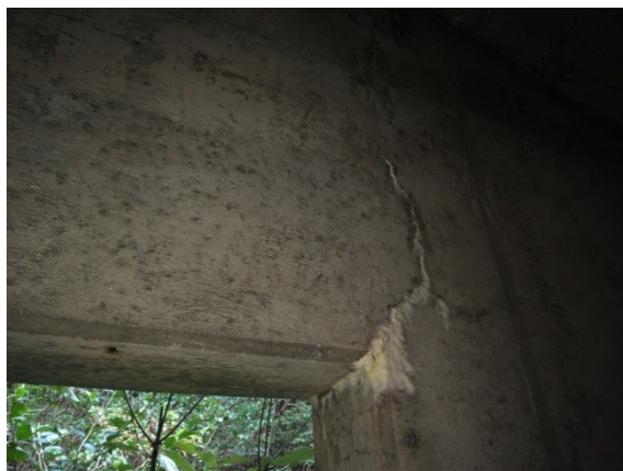
写真 漏水による白華現象／要是正
