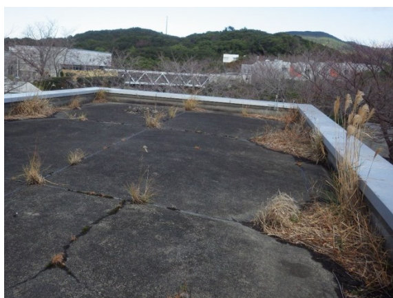
写真 屋上の雑草繁茂／要清掃・補修
