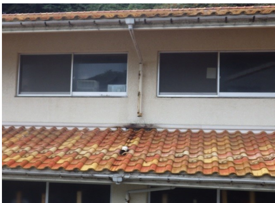
写真 樋破損／要補修
