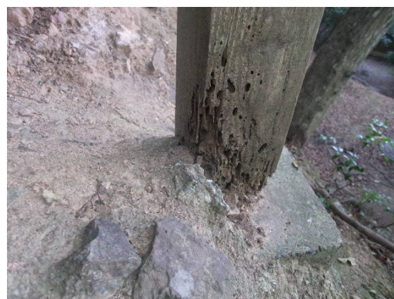
写真 白アリによる腐食／要是正
