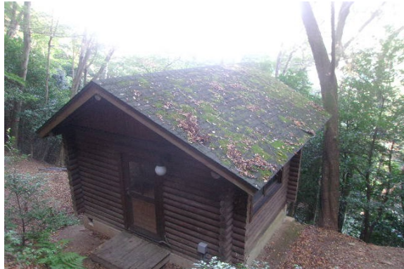
写真 屋根繁茂／要清掃
