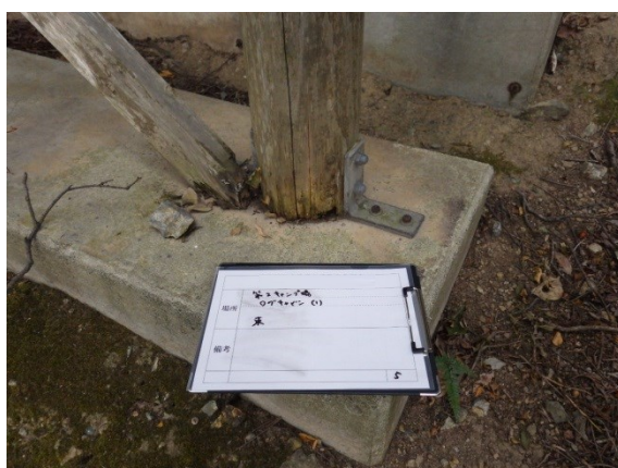
写真 土台の腐食／要是正
