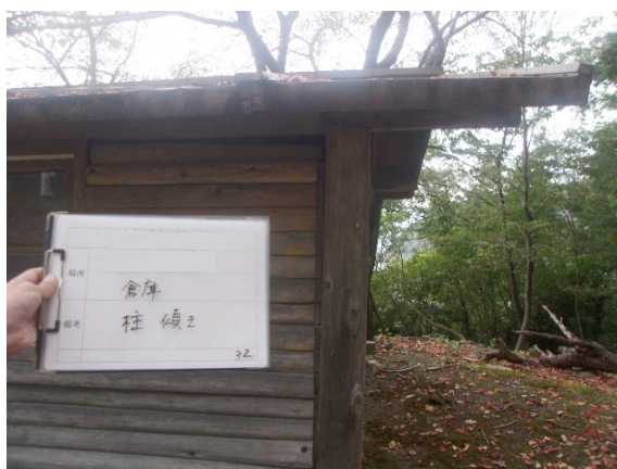
写真 柱の傾き／要是正
